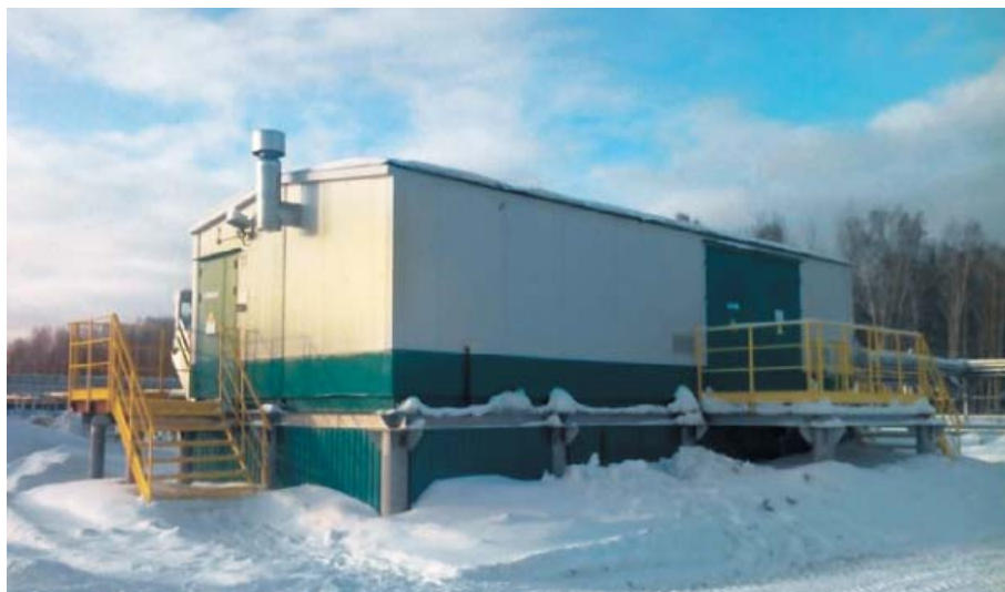
Рис. 1. Общий вид комплектной подстанции до 35 кВ в утепленном корпусе
