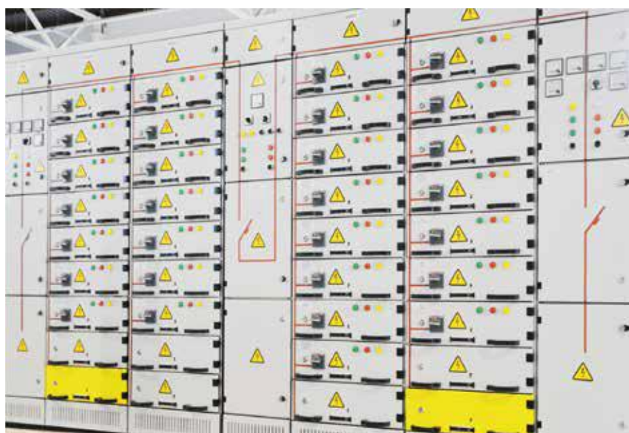
Рис. 1. Современное электротехническое оборудование систем электроснабжения
