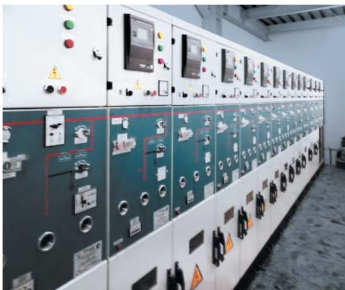
Рис. 1. Общий вид комплектного распределительного устройства
