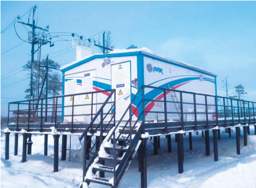
Рис. 1. Общий вид цифровой подстанции для электрогенерирующих устройств
